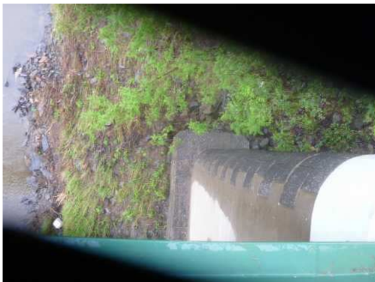
Odplavený terén v okolí pilíře 5.
